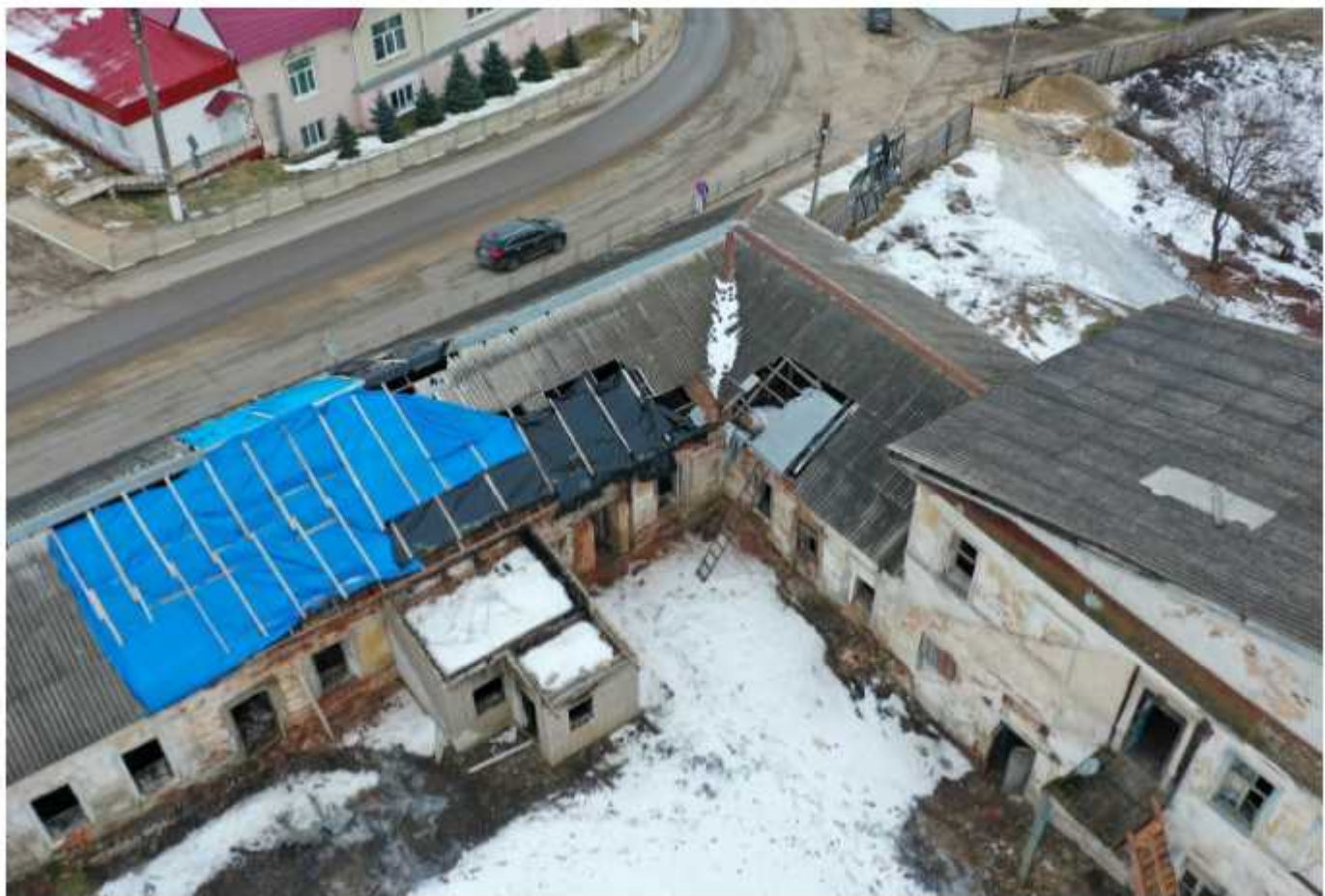
Фото 4. Разрушение кровли восточной пристройки.
