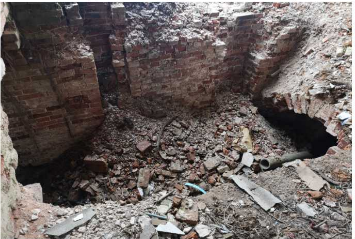
Фото 10. Обрушение части свода цокольного этажа в осях 2-4/А1-В.
