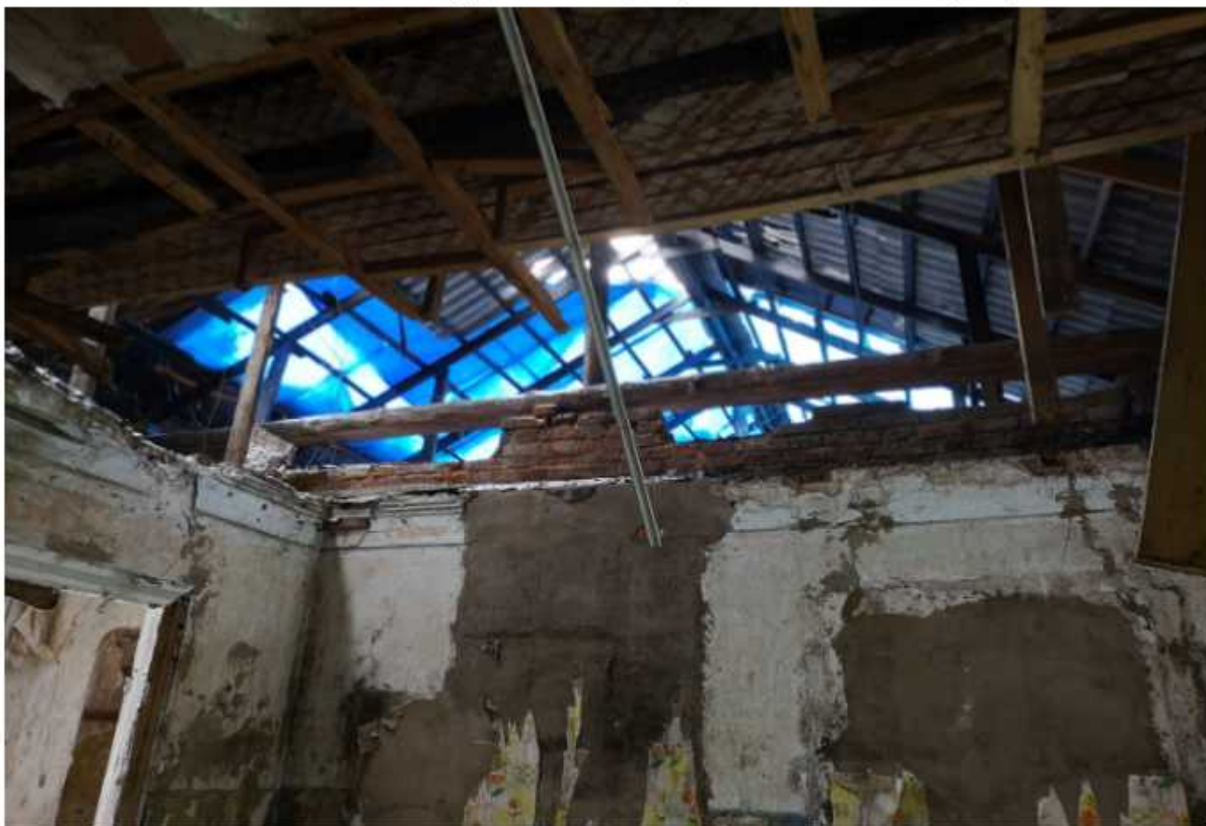
Фото 22. Состояние чердачного перекрытия восточной пристройки.
