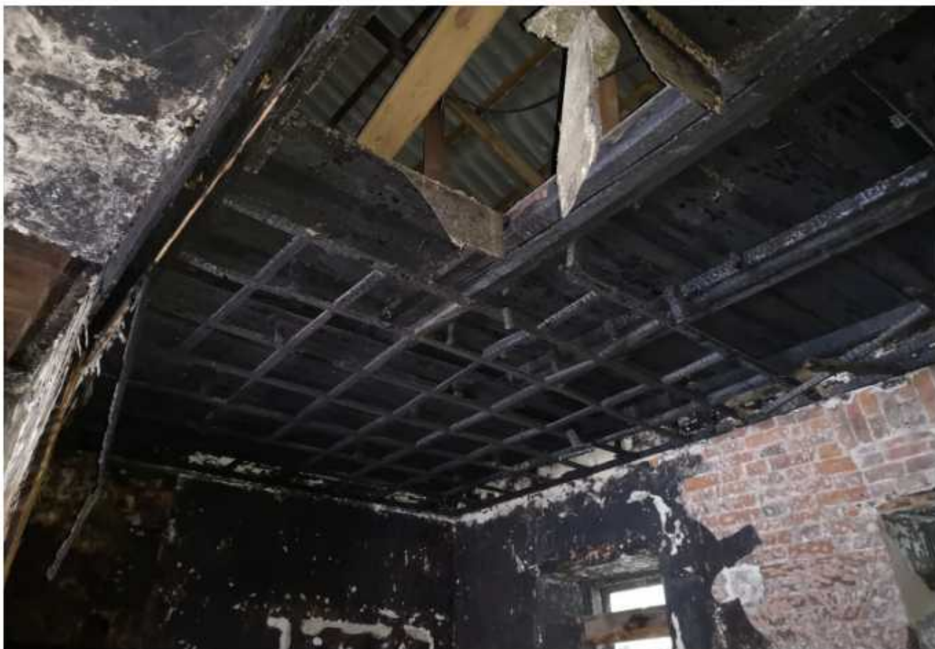
Фото 21. Состояние чердачного перекрытия восточной пристройки.
