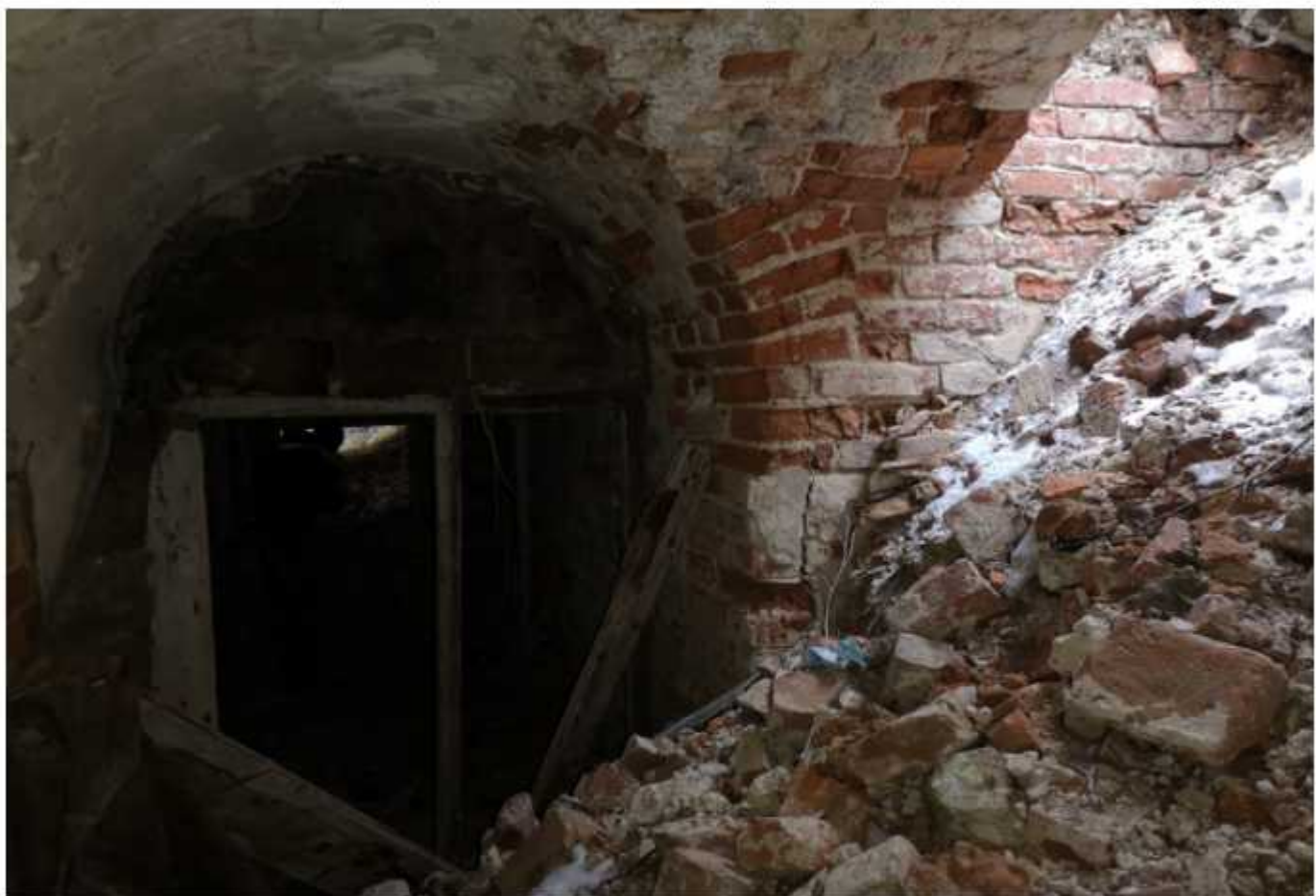
Фото 14. Разрушенный вход в цокольный этаж западной пристройки в осях 2/Д.
