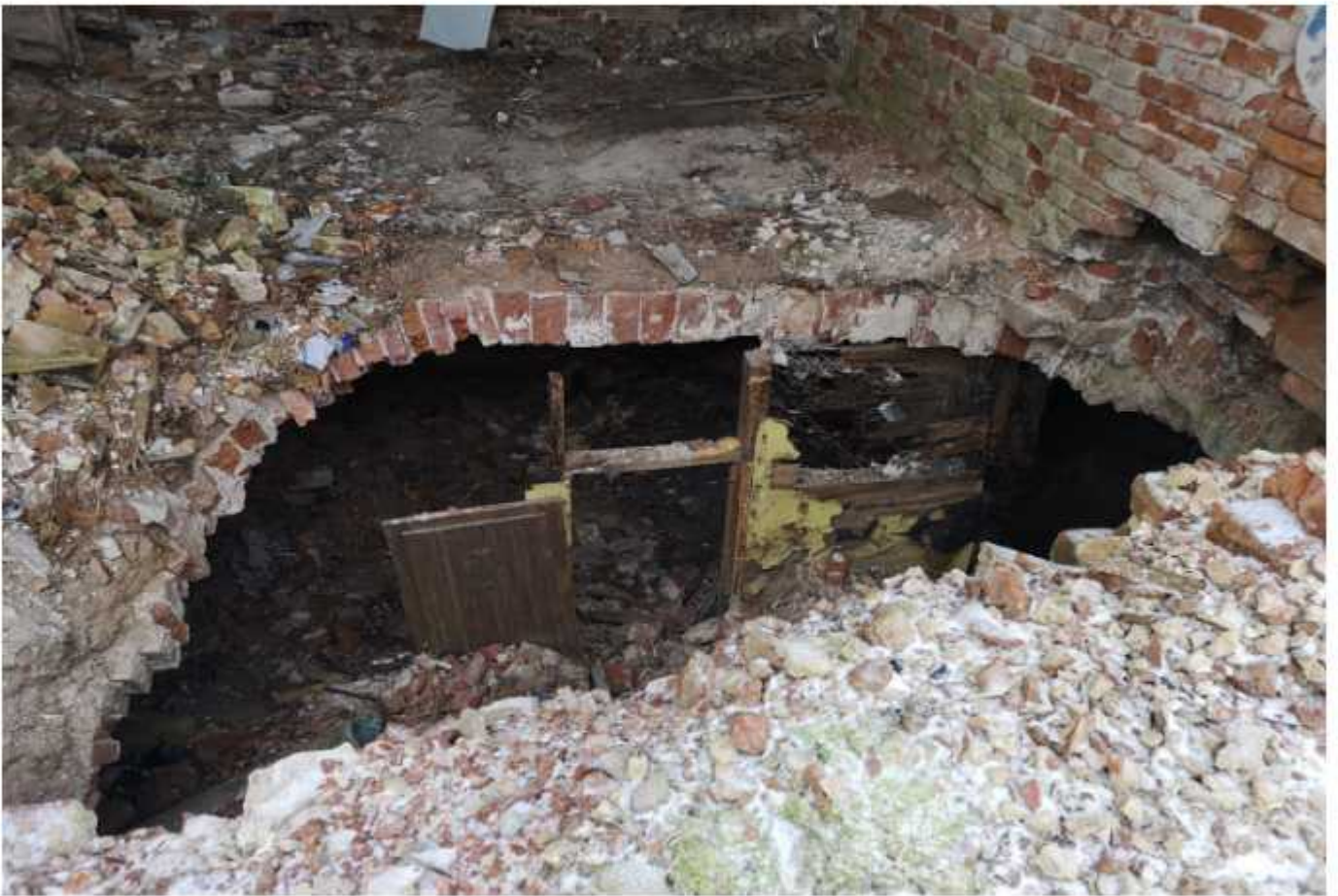
Фото 9. Обрушение части свода цокольного этажа в осях 2-4/А1-В.
