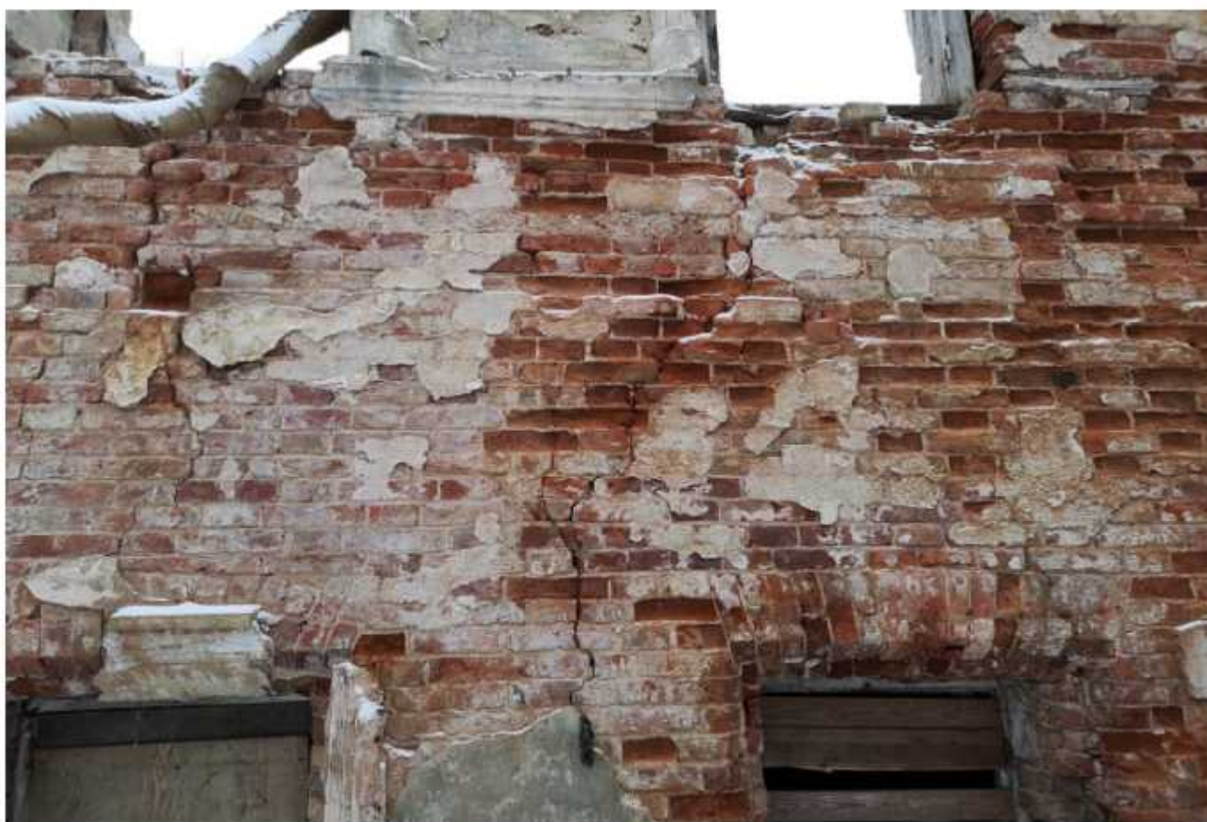
Фото 12. Трещина в наружной стене в осях 1/Д.
